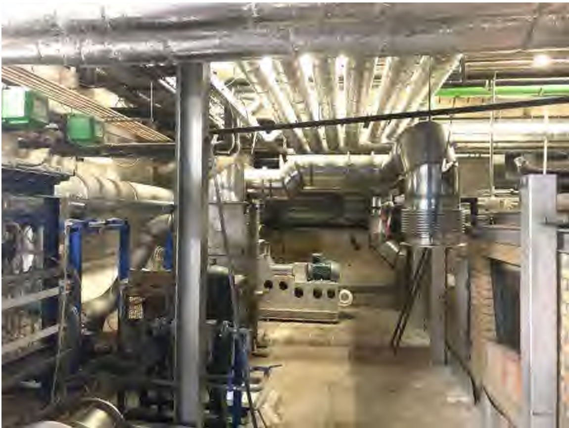
Abbildung 3.29: Vorbereitete Abgasentnahme mit Heißluftwärmetauscher (mittig hinter Säule) und Saugzuggebläse (Hintergrund) (Quelle: UAS)
