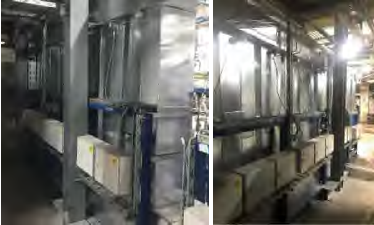
Abbildung 3.28: Rückseitige Ansicht der Vorwärmstationen mit den isolierten Wärmetauschern für Erdgas und Sauerstoff, sowie den Absaugeinheiten für die Leckageüberwachung, (Quelle: UAS)
