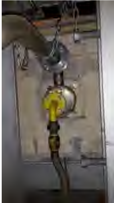
Abbildung 3.33: Installierter Preheating-Brenner mit „kalten“ Anschlüssen und provisorischer Halterung über Kette (Quelle: UAS)
