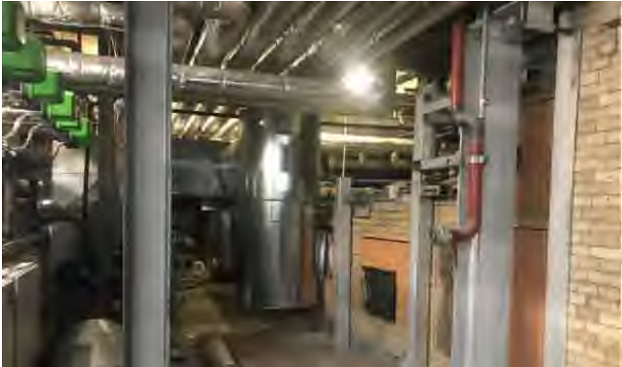
Abbildung 3.30: Abgasentnahme aus dem Abgaskanal (Quelle: UAS)
