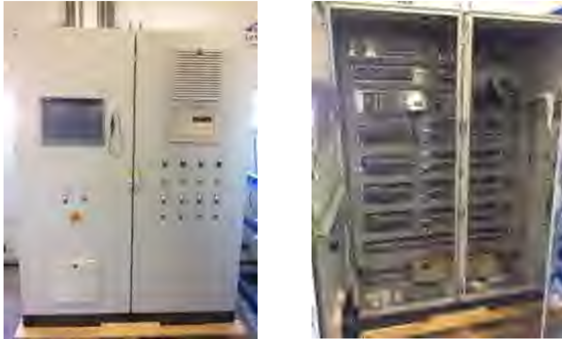
Abbildung 3.15: Links: Steuerschrank der 4er-Station inkl. Touchpanel, Bedien- und Anzeigeelemente und Auswerteeinheit der Gaswarnzentrale, Rechts: Steuerschrank Innenansicht inkl. Siemens S-1200 SPS (Quelle: UAS)
