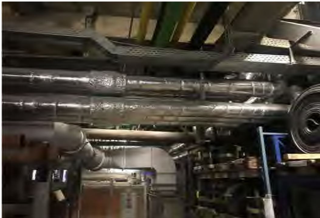
Abbildung 3.31: Brennerversorgungsleitungen mit vorgewärmtem Sauerstoff und Erdgas unter der Wanne (Quelle: UAS)
