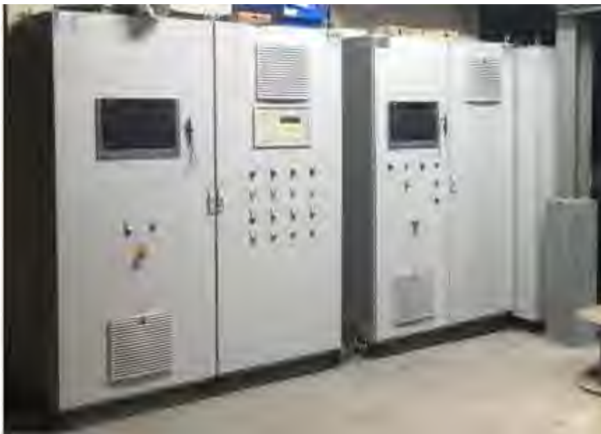
Abbildung 3.27: Schaltschränke bei Zwiesel Kristallglas AG (links Steuerschrank Vorwärmstationen, Mitte Steuerschrank Brennerregelung, rechts rückseitig Leistungsschrank), (Quelle: UAS)
