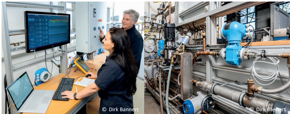
PRÜF- UND TESTSTÄNDE FÜR GASGERÄTE / KWK-ANLAGEN BIS 20 kW ELEKTRISCH
