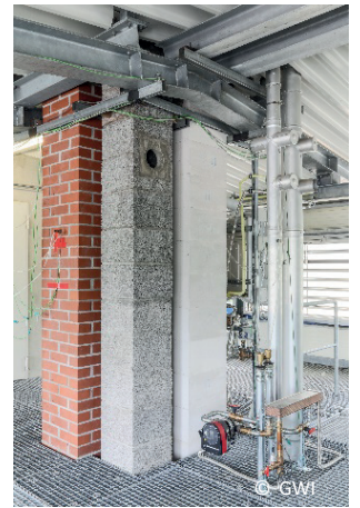
SCHORNSTEINANLAGE ÜBER 3 ETAGEN
