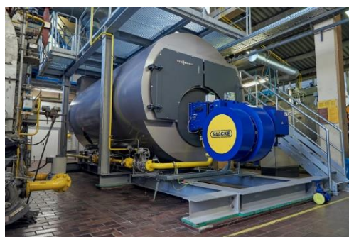
Flammrohrkessel mit Saacke-Brenner (Quelle: Saacke)
