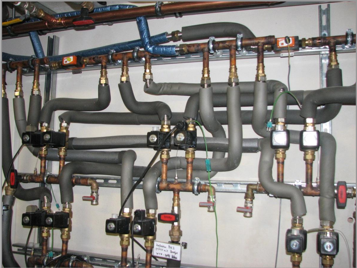
Abbildung 9-3: Installation zum Umschalten der drei Kollektoren am Gaswärme-Institut Essen
