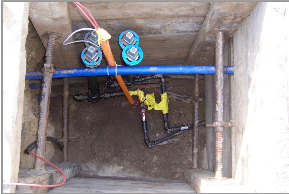
Abbildung 10-2: Anschluss Erdwärmekollektor am Standort Berlin-Nottepfad
