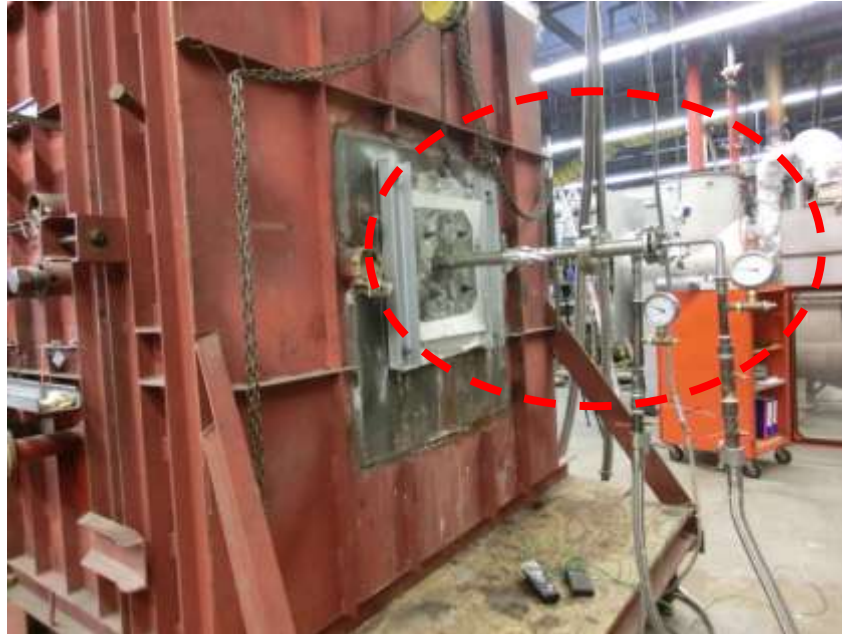
Bild 29: Eingebauter Überschallbrenner für den Betrieb mit Erdgas
