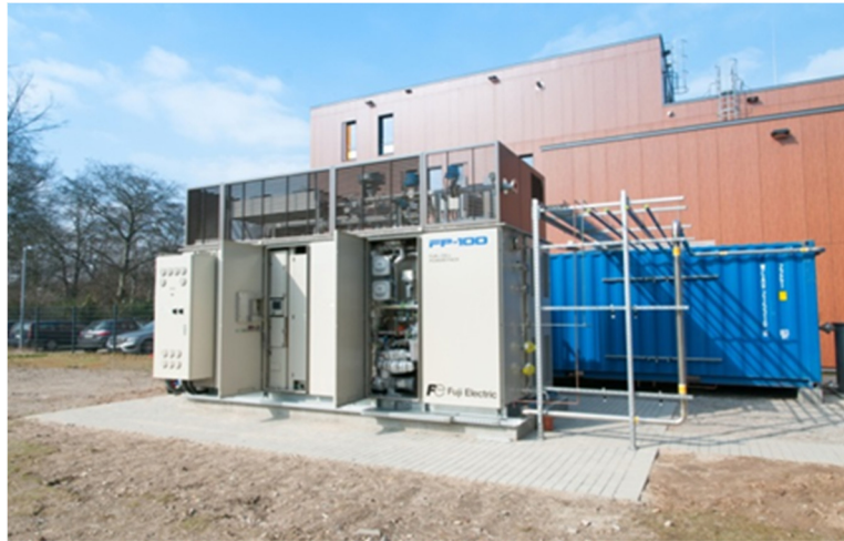
Abbildung 40: QuattroGeneration-Anlage am ZBT Duisburg
