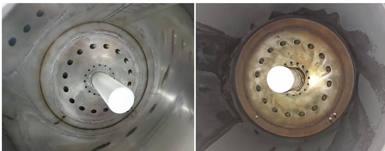
Abbildung 6.11: 300 kW Bio-Mehrstoffbrenner im Neuzustand (links) und nach ca. 50 Betriebsstunden (rechts).
