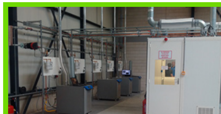
Laboreinrichtung bei MTT
