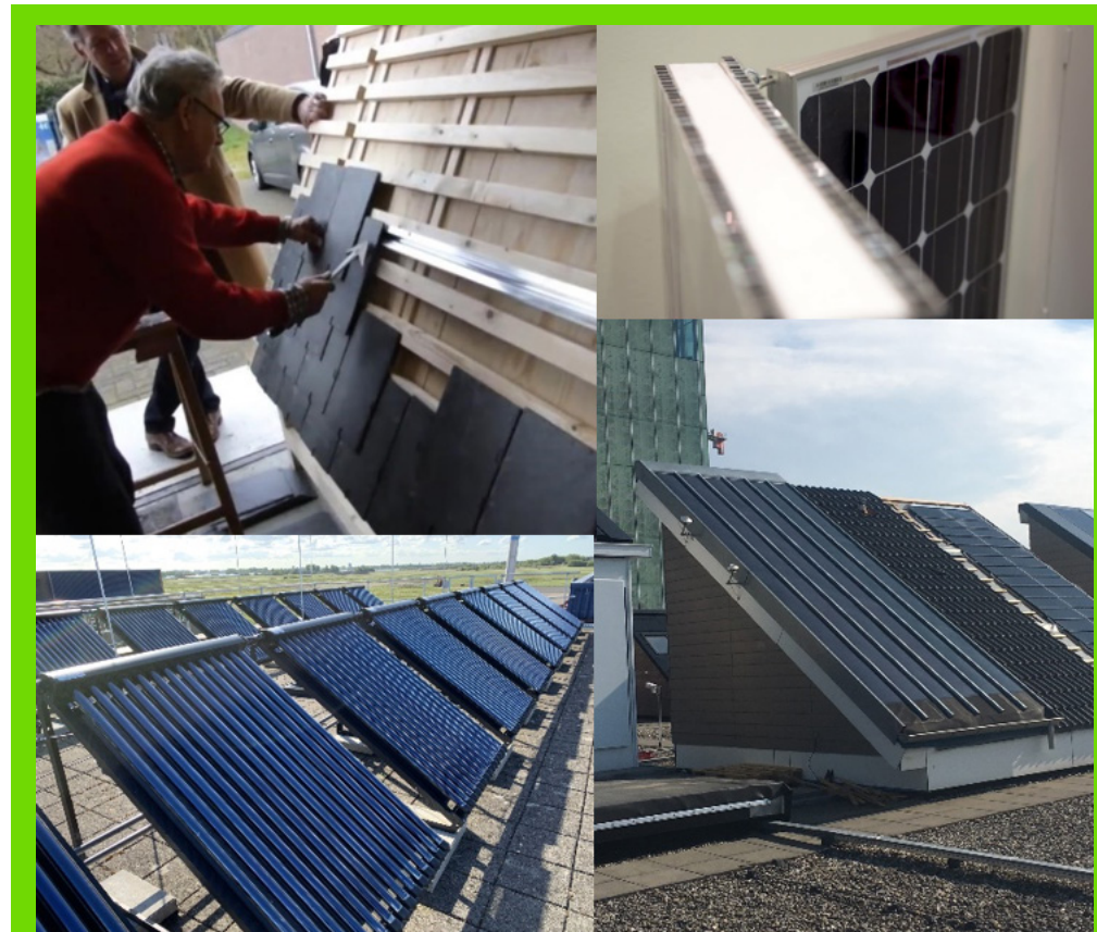
Fotos im Uhrzeigersinn v.l.n.r.: - Q-roof (Chatim B.V.) - ActiveWall (Saint Trofee) - Supro Cooling (Supro New Business B.V.) - Energiedak (SolarTech International B.V.)
