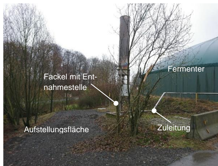
Abbildung 5.1: Ausstellungfläche für die Feldversuche an der Biogasanlage in Bielefeld Dornberg. (Quelle: DBI)
