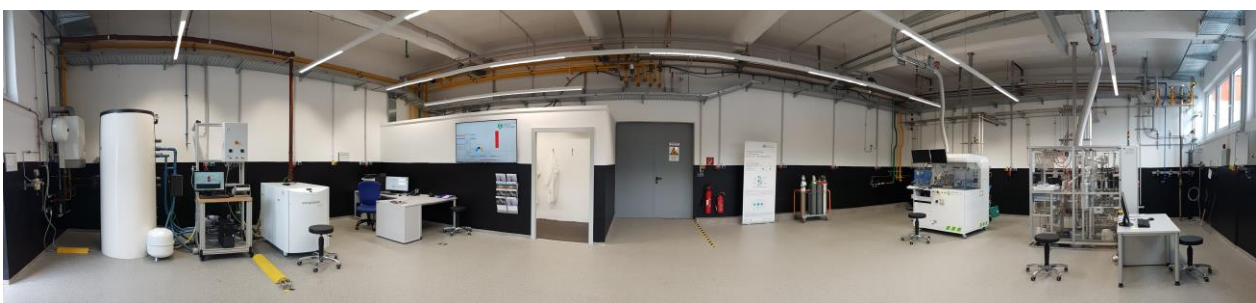
Abbildung 2: PtX-Demonstrationsplattform des Virtuellen Instituts - Strom zu Gas und Wärme
