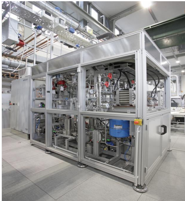
Abbildung 93: 100 kW PEM-Elektrolyseur am IEK-14
