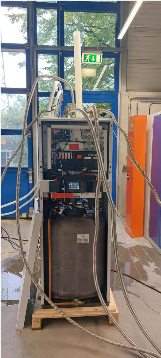
Abbildung 57 – Prüfstand: Brennwertkessel, Wärmetauscher, Trinkwarmwasserspeicher und Anlagensteuerung
