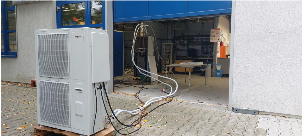
Abbildung 55 -Prüfstand: Außeneinheit Wärmepumpe
