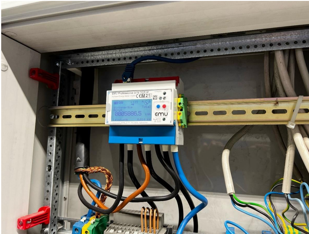
Abbildung 3-57: Stromzähler in einer Unterverteilung am GWI (Foto GWI)
