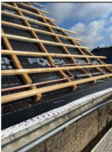
Abbildung 296: vorbereiteter thermischer Anschluss SHDS
