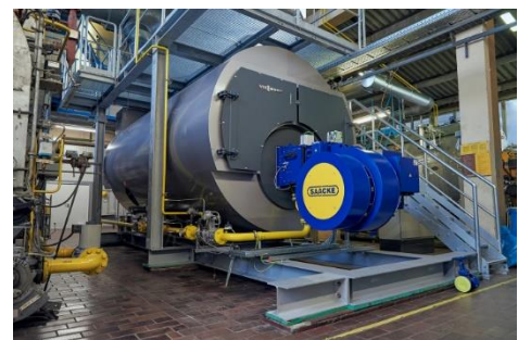
Flammrohrkessel mit Saacke-Brenner (Quelle: Saacke)
