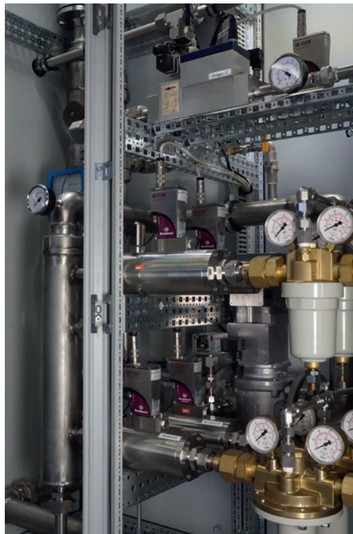
Abb. 11: Innenansicht der Gasmischanlage bis 1 MW Leistung
