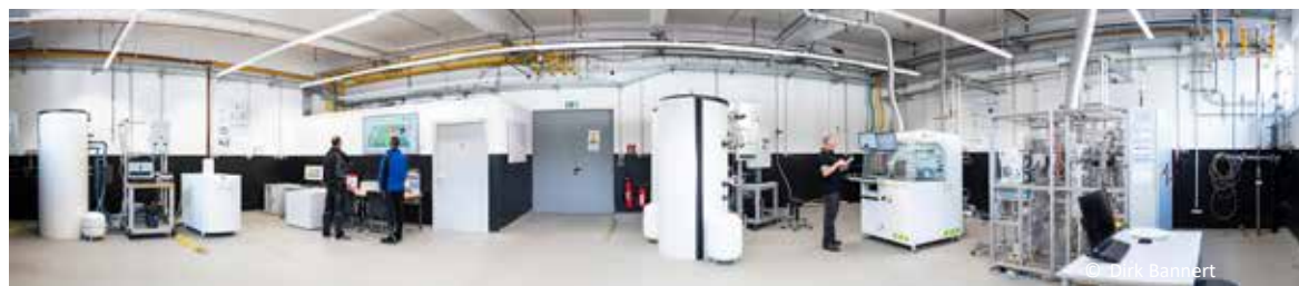
PTX-DEMONSTRATIONSZENTRUM, BESTEHEND AUS PEM ELEKTROLYSEUR, KATALYTISCHER METHANISIERUNG, POWER-TO-HEAT-ANLAGE UND KWK-SYSTEM
