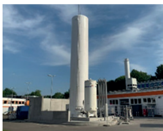
LNG-TECHNIKUMSANLAGE MIT EINER KAPAZITÄT VON 24 T
